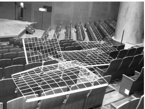
コンサートホールの落下した天井材
