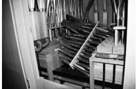
破損した内部パイプ
