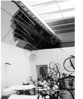
展示室の天井の一部が落下
